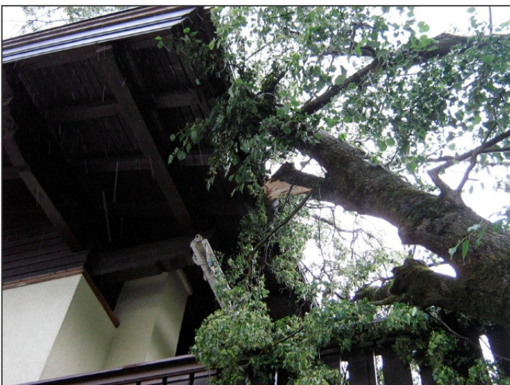
Der Baum beschädigte das Dach und die Terrasse
